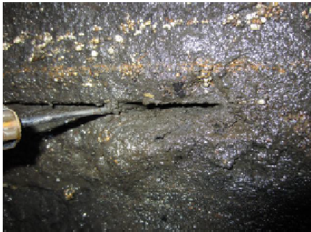
Typisk läckage på äldre avskiljare. Gummipackningen har sedan länge vittrat sönder med in- och utläckage som följd.
