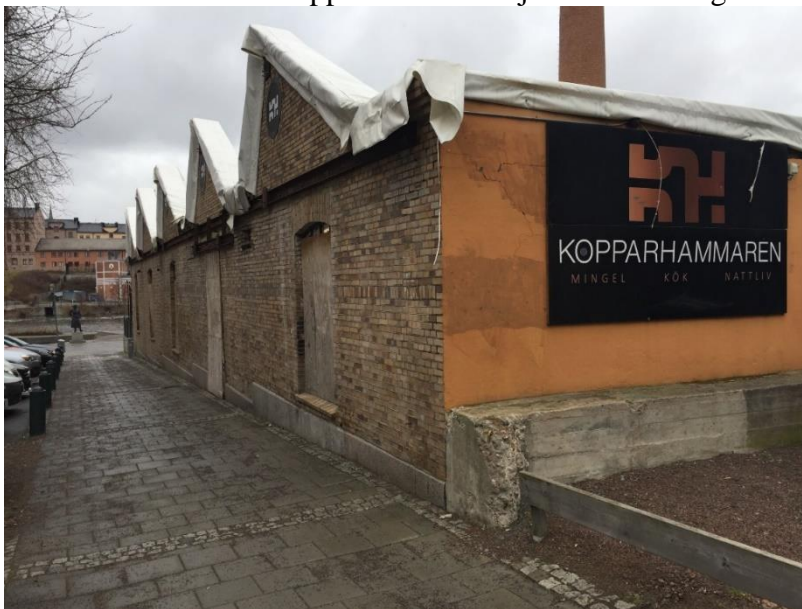
Figur 9 Befintlig byggnad inom fastigheten som skadats i brand 2018.
