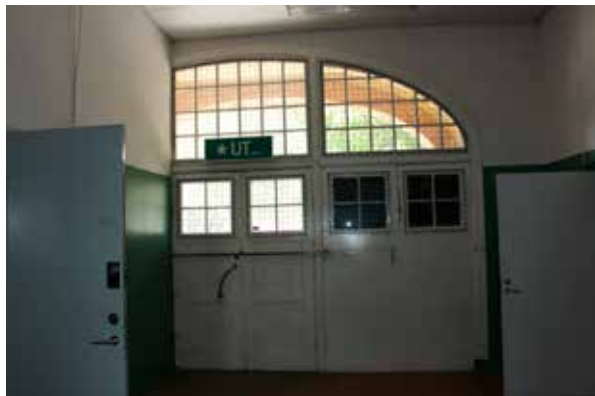
Entrén är avskuren av en mellanvägg invändigt.
