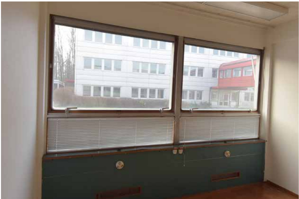
Interiör från kontorsbyggnad 1. Denna byggnad har många egensinniga lösningar och är mycket välbevarad.
